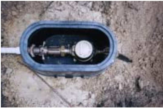
PE water service.
